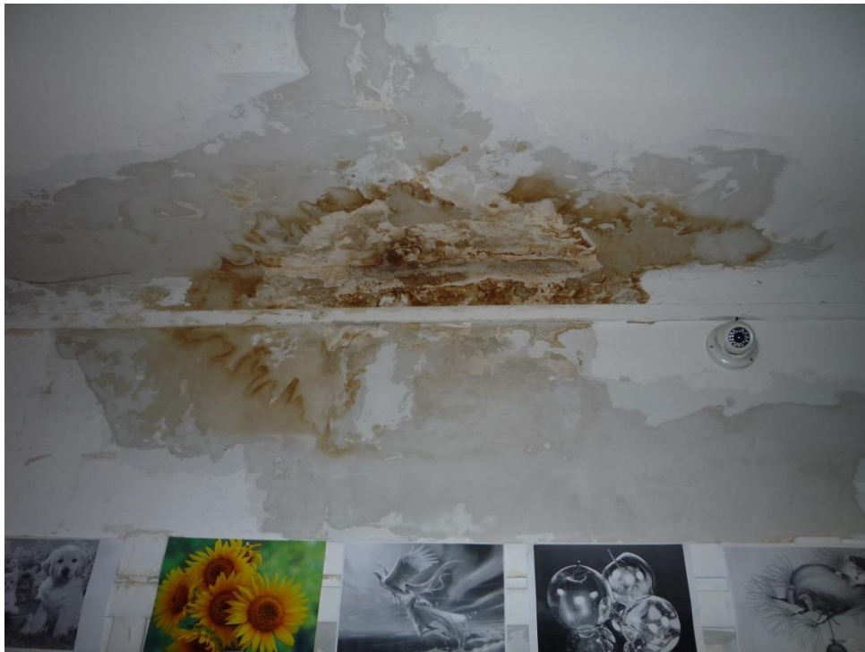
1. sz. kép: A mennyezeten a tetőről történő ázás nyomok látszottak.
